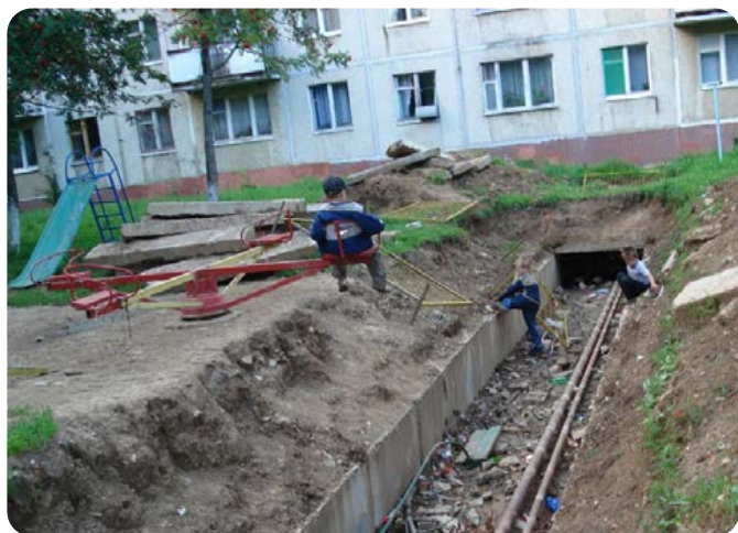
Игровое оборудование расположено в охранной зоне теплотрассы.
